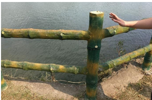
虎月亭周邊護欄老舊且間隙過大
