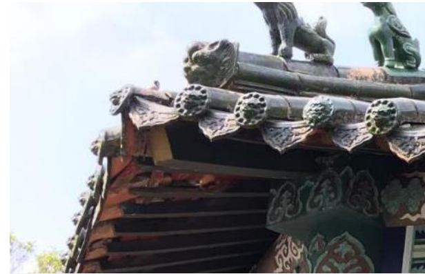
虎月亭屋簷木料已出現破損
