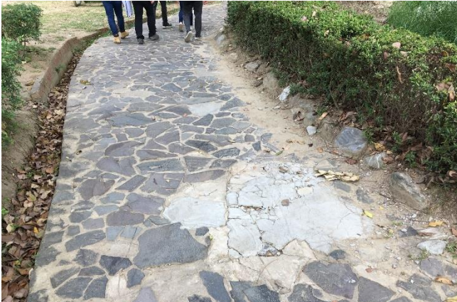
親水步道：亂石砌步道多處破損難以行走
