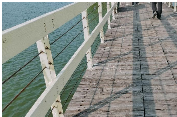
壩體棧道護欄已老舊需更新
