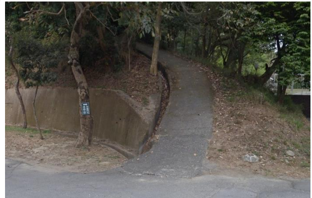
既有陡坡鋪面狀況不佳
