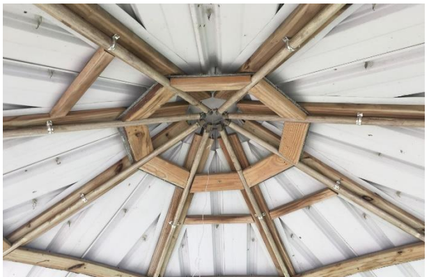
涼亭屋頂內部骨架外觀較為臨時性
