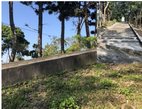
周邊既有階梯地基掏空
