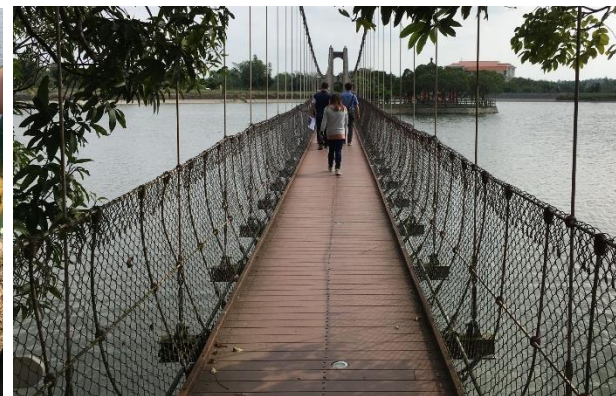
現況虎月吊橋護欄網材已老舊
