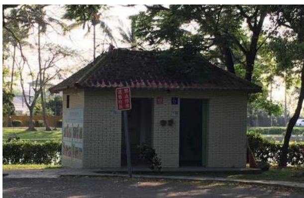
廁所 G 現況照片
