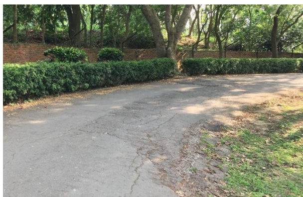
AC 道路多處已破損
