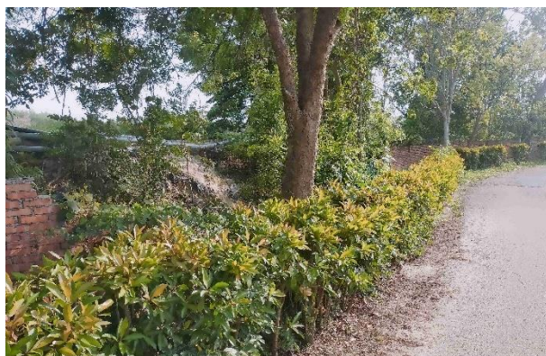
局部圍牆有倒塌情形
