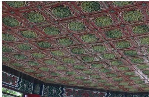
虎月亭天花板已下陷
