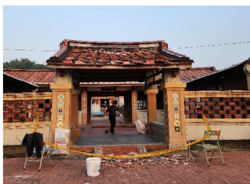
照片 1 門樓屋瓦嚴重滑動
