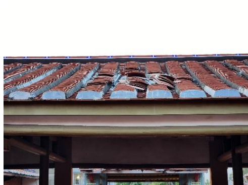
照片 2 公廳屋面瓦作損壞
