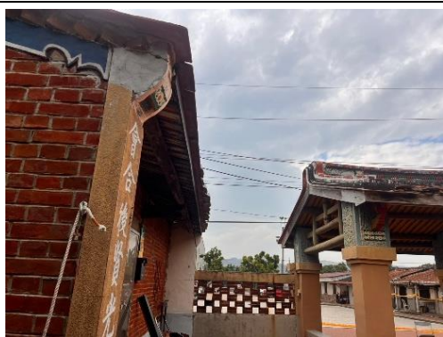
照片 3 貴賓室屋頂損壞
