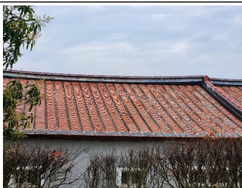
照片 6 祖祠堂屋面損壞
