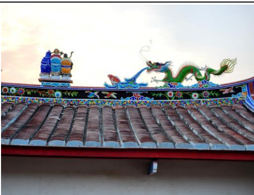
照片 5 神明廳屋面損壞
