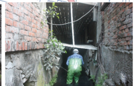
E. 河溝上方全臺首學大樓後方木棧板(占用河溝)
