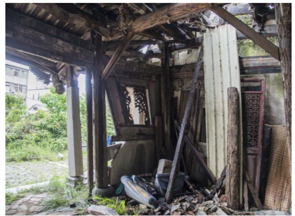
照 6：正廳內部木構件現況損壞狀況。
