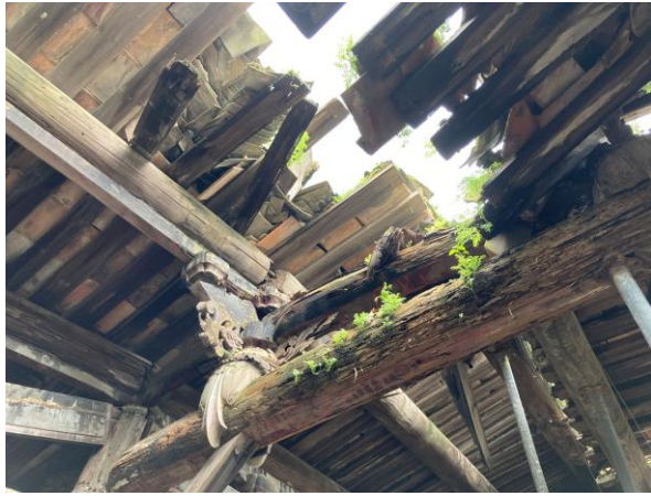
照 7：正廳內屋頂崩塌處棟架木構件表面雜草蔓生。
