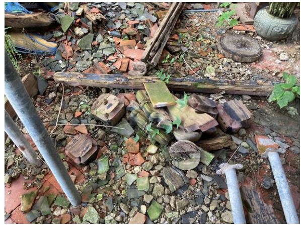
照 8：正廳棟架上木構件掉落地面。
