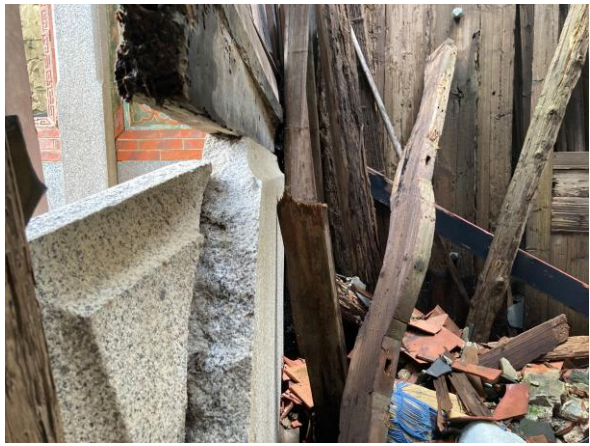
照 9：正廳前步口花崗石台度斷裂及內側牆面與地面有掉落木構件堆置。
