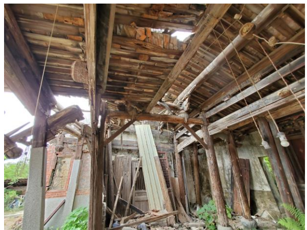
照 2：明間右側棟架，前一架與中脊桁樑斷落及棟架上部分木構件掉落。
