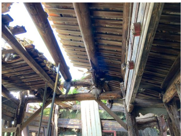
照 11：正廳內棟架有崩塌危險者，目前已局部設置暫時性支撐。
