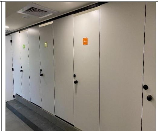
各類便器皆設有完整獨立隔間
