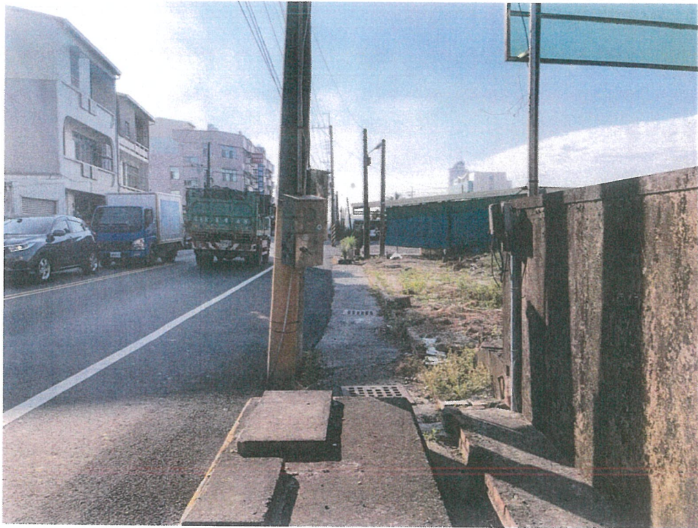
保東路與保東路 88 巷口下游段之北側側溝現況
