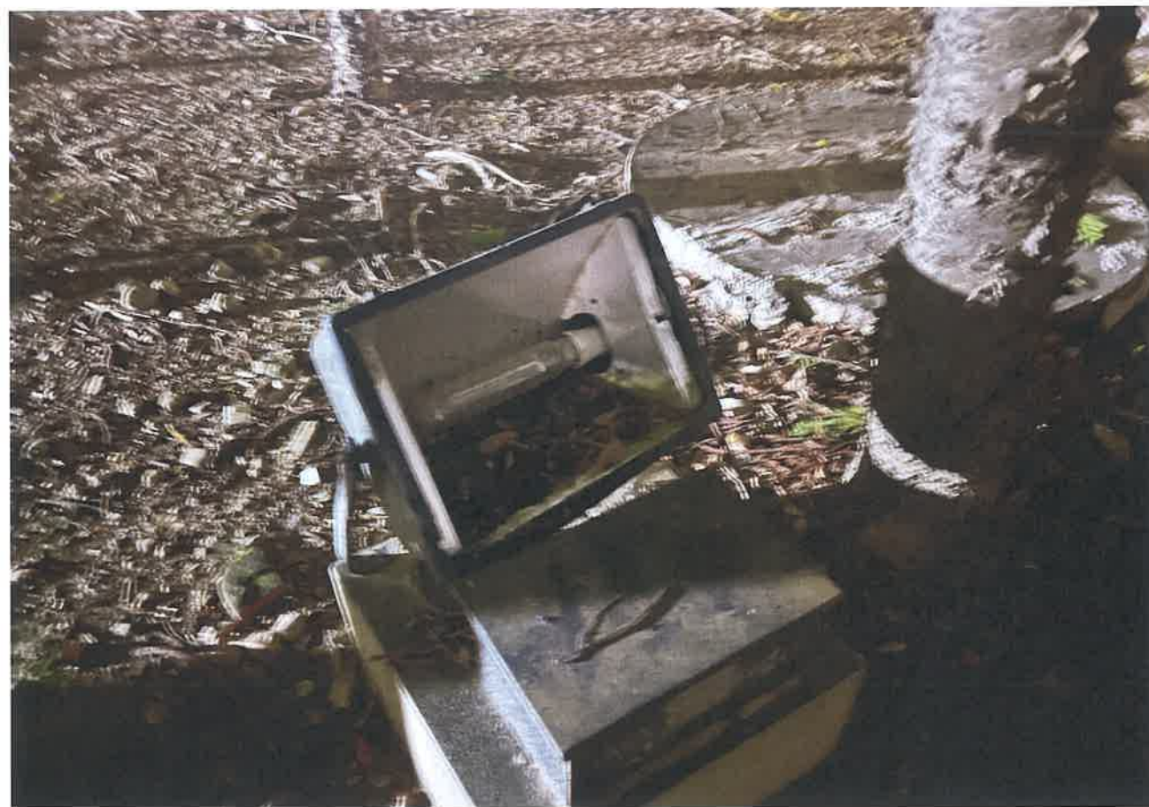
體育館/游泳池外牆投射燈
