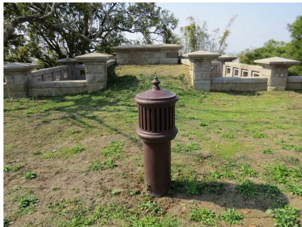
■淨水池入口屋頂通風器
