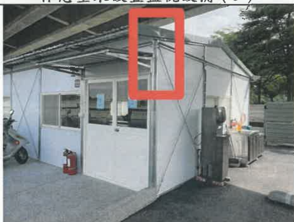
照明設備不足 ( 7 )
