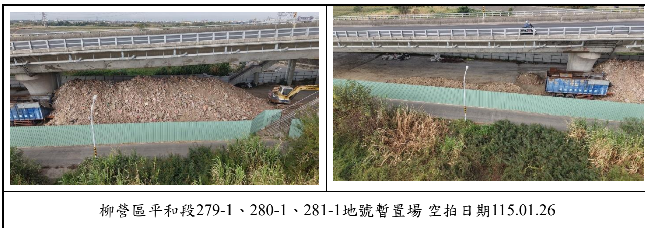
圖 2、災後廢棄物暫置場或掩埋場現況(3/3)
