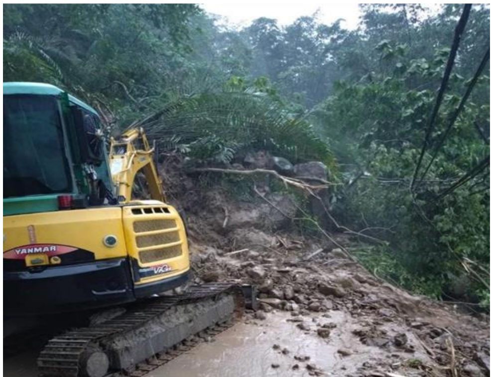
南化區關山里南 179 線土石坍方聯外道路中斷搶修
