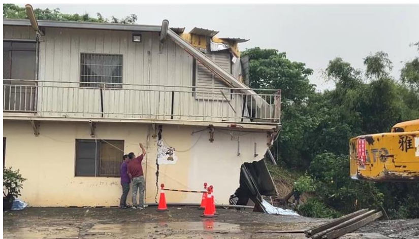
柳營區旭山里滑落邊坡搶救
