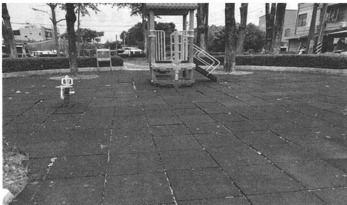
設施現況：空曠無樹蔭，無遮陽設施
