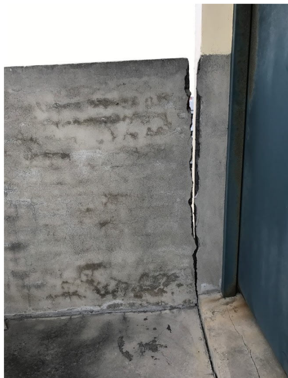
伸縮縫處嚴重龜裂
