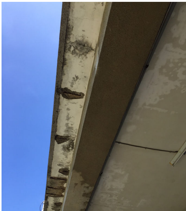
屋簷混凝土剝落、鋼筋外露
