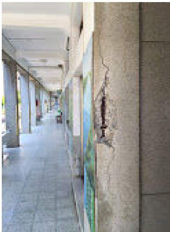
結構柱混凝土剝落、鋼筋外露
