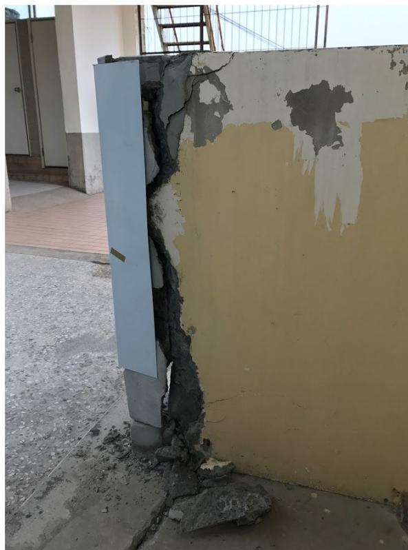
牆面混凝土大面積剝落、鋼筋外露
