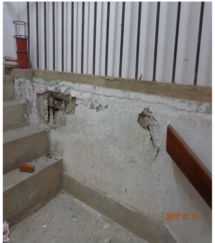
地下室往一樓梯間牆保護層剝落，鋼筋外露
