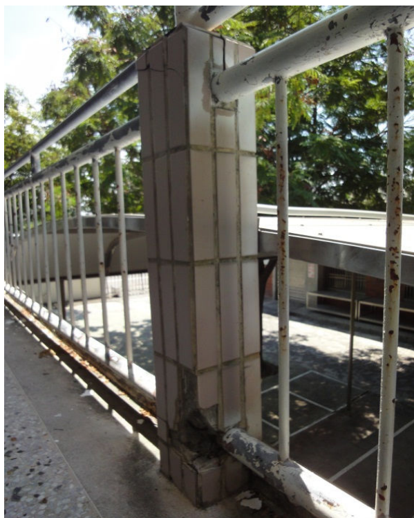
欄杆混凝土剝落、龜裂
