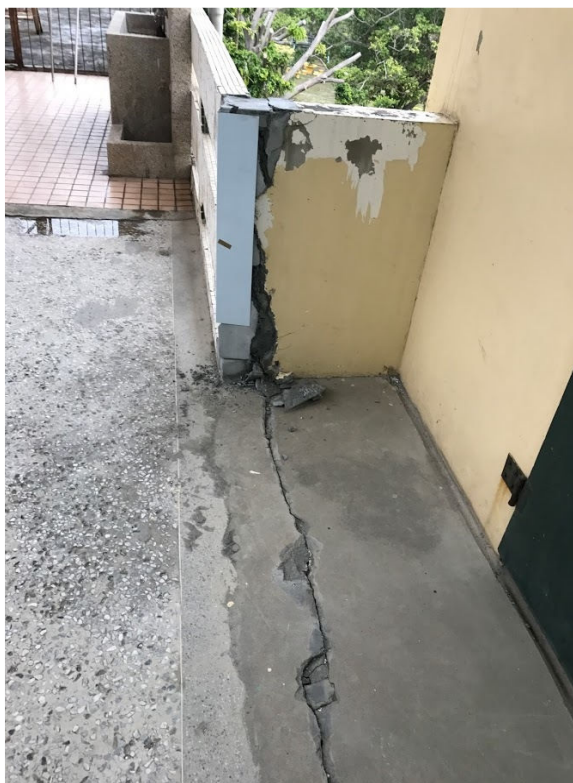
地坪嚴重龜裂
