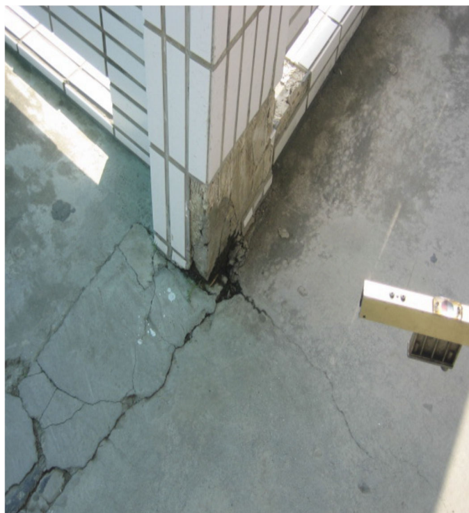
柱面混凝土剝落、鋼筋外露、地板嚴重龜裂
