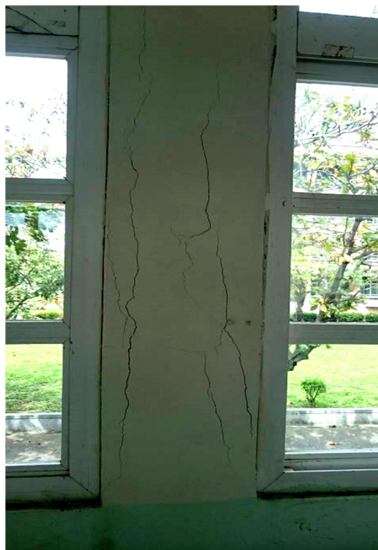
教室結構柱大面積龜裂
