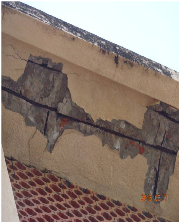
雨遮板裂縫、保護層剝落、鋼筋外露
