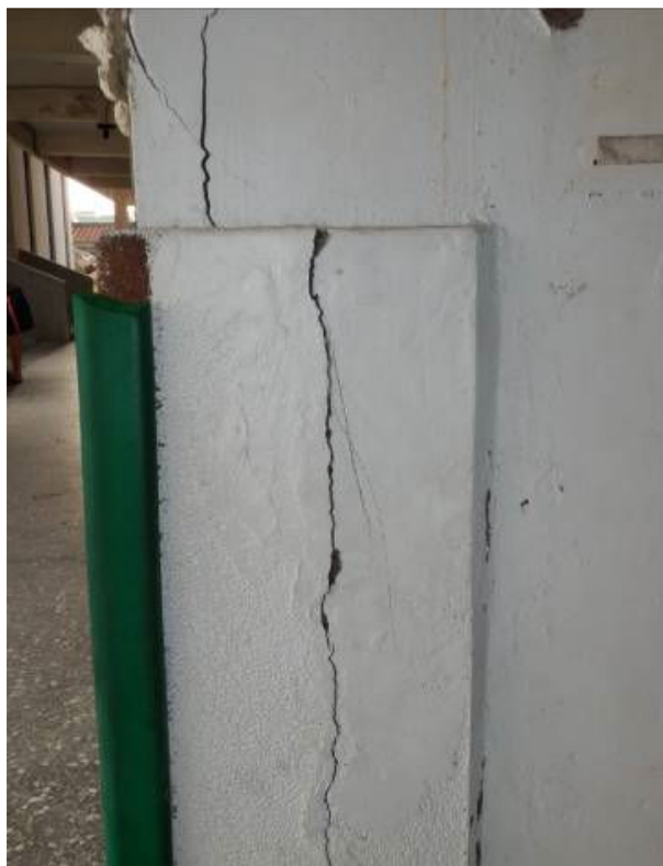
牆面大幅垂直龜裂
