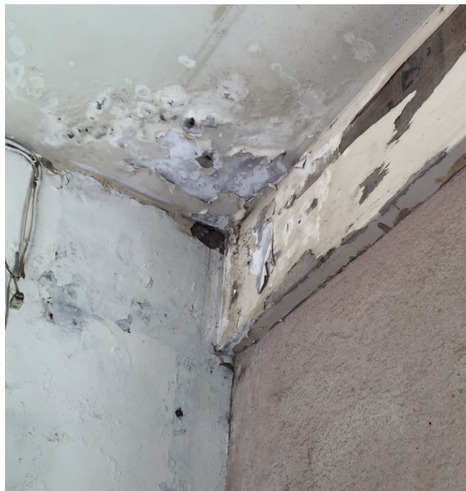
樓頂板混凝土大量剝落
