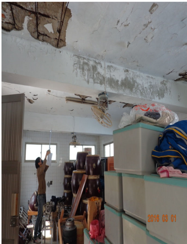
樓頂板混凝土剝落、鋼筋外露，甚至斷裂
