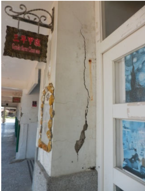
結構柱龜裂、混凝土剝落
