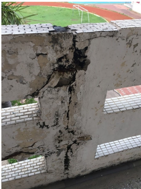
2樓女兒牆混凝土剝落、鋼筋外露
