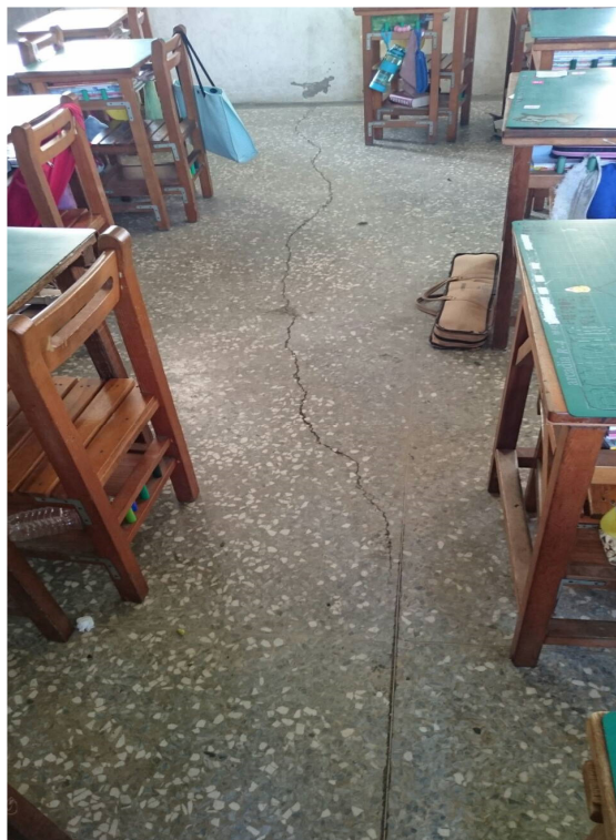
教室地板嚴重龜裂
