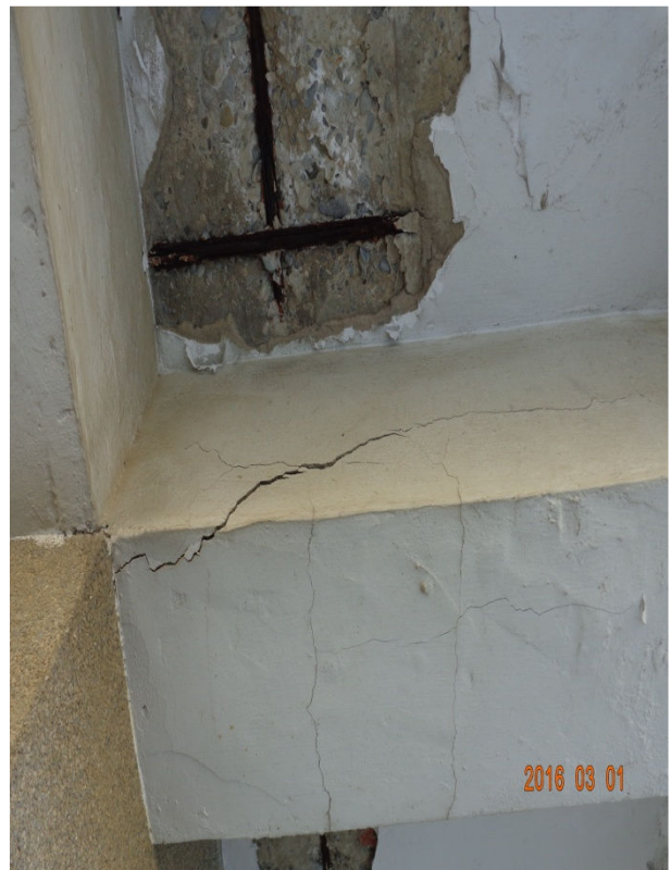
走廊懸臂樑龜裂、樓頂板混凝土剝落
