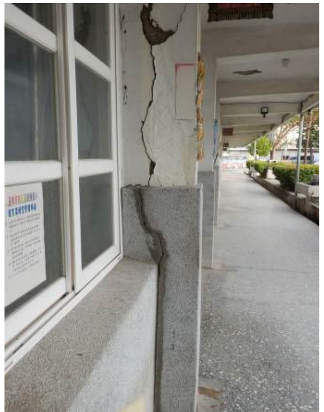
結構柱受擠壓，已產生爆柱情形
