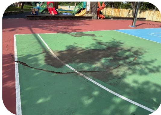
學校籃球場地板龜裂破損
