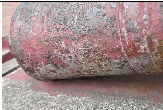
圖 6-3、表面保護層老化、表面金屬剝落
